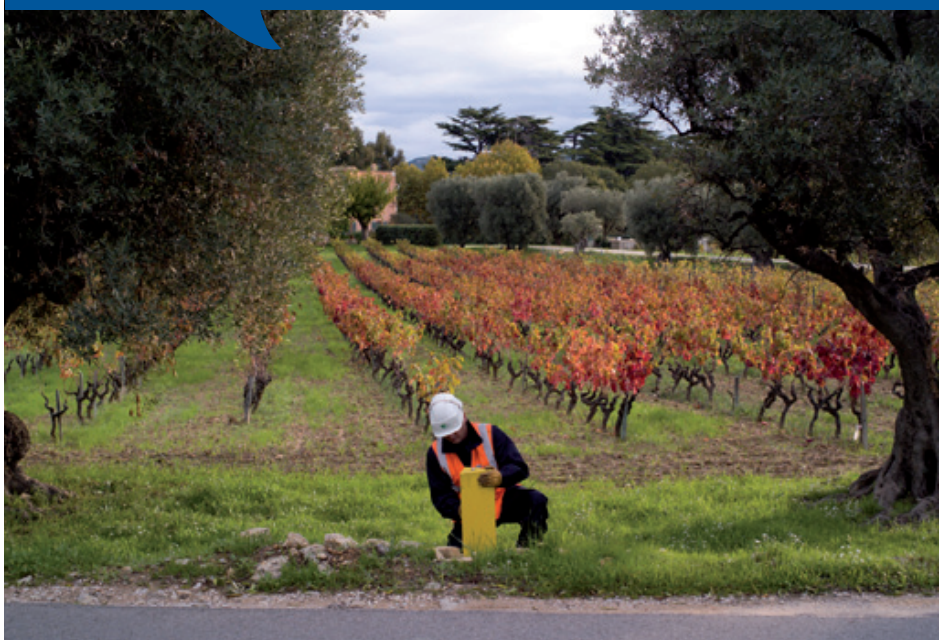
Entretien d'une balise GRTgaz
