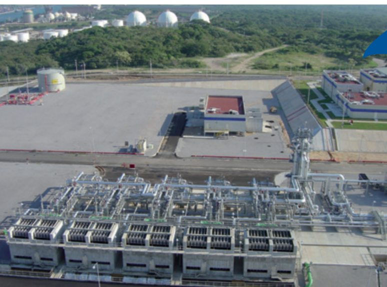
Vaporisateurs ou échangeurs de chaleur ORV (Open Rack Vaporizers)
