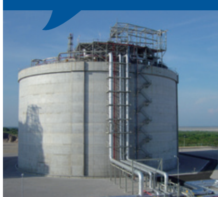
Réservoir de GNL
