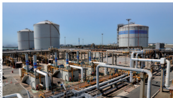
Vue sur les trois réservoirs actuels du terminal méthanier de Fos Tonkin
