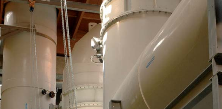
• Salle de désodorisation de l'unité de traitement des pollutions azotées de Seine aval
