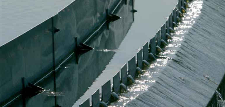
• Surverse d'un clarificateur.
