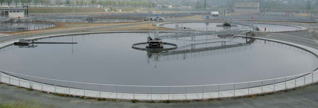
• Bassin de décantation à Seine aval
