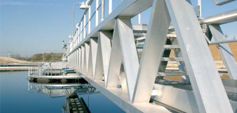
• Traitement des eaux à l'usine Seine amont
