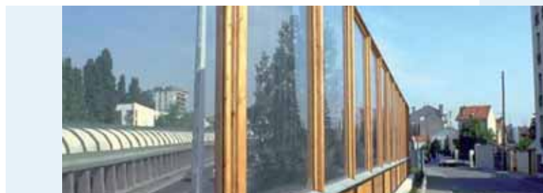
Ecrans réfléchissants sur l'A86 à Montreuil
