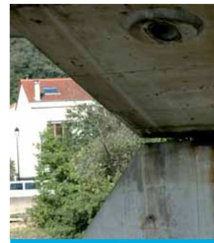
Rejet d'eau dans la Marne
