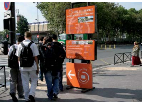
Des cheminements bien signalisés garantiront la sécurité des piétons, des usagers des transports en commun et des écoliers © Mairie de Paris.
