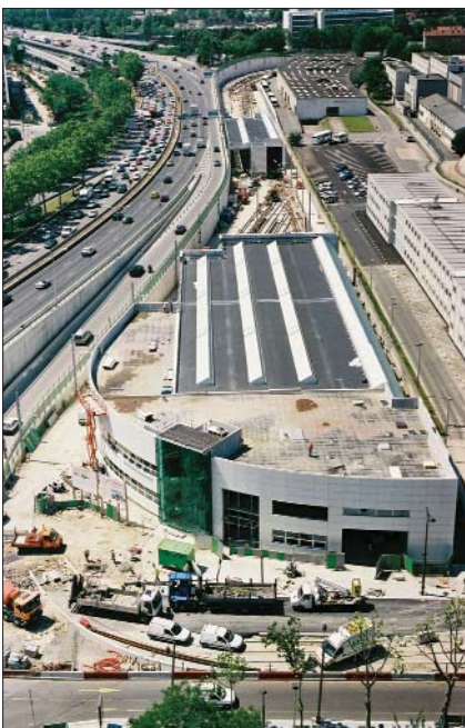
Le site de maintenance Lucotte, sur le premier tronçon du tramway T3 © Mairie de Paris
