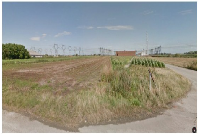
Vue sur le poste de Warande depuis le chemin du Meulengracht à Bourbourg (source : Google®)
