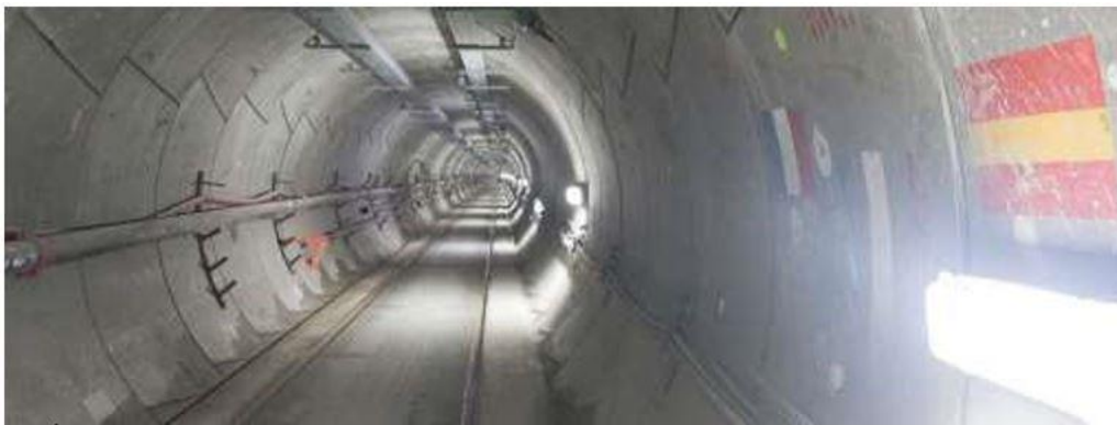
CRÉDIT PHOTO : RTE FRANCE
