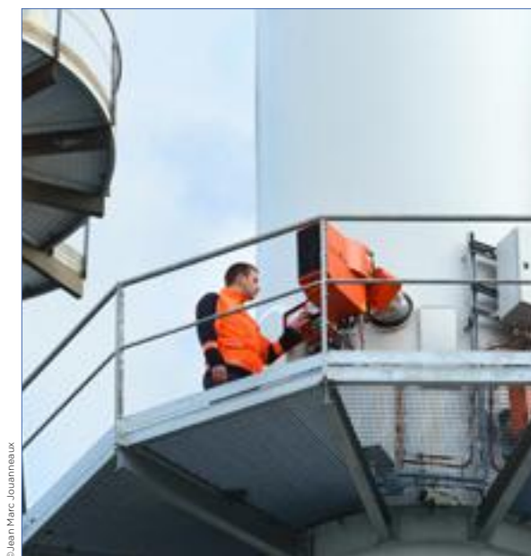
Vérification par le Pôle Environnement du Laboratoire des appareils d'auto surveillance installés sur les cheminées des centrales thermiques
