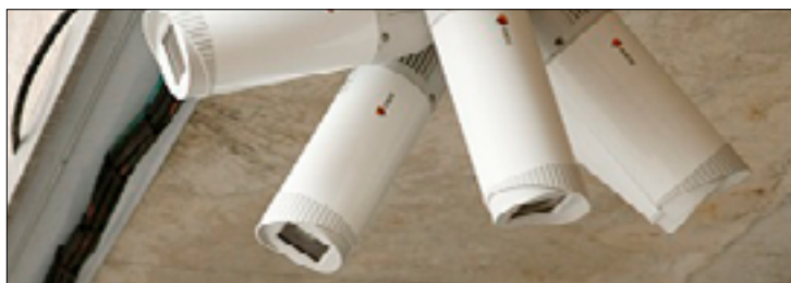
EXEMPLE DE SYSTÈME DE VIDÉO EN STATION (SAOUZELONG, LIGNE B)
