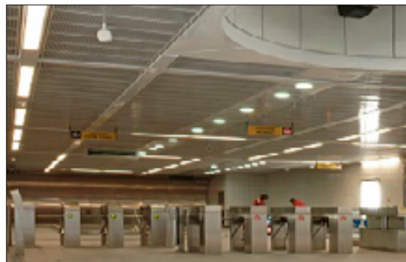
EXEMPLE D'ÉCLAIRAGE EN STATION (LA VACHE, LIGNE B) ©SAADA-FERRER
