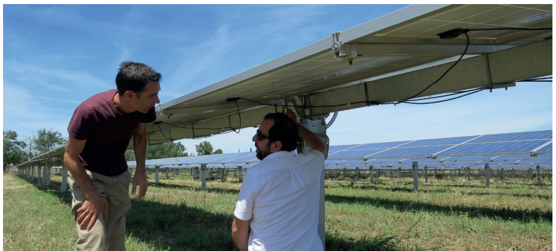
Parc photovoltaïque Le Soler
