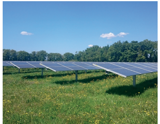
Parc photovoltaïque Arkolia Énergies Le Soler
