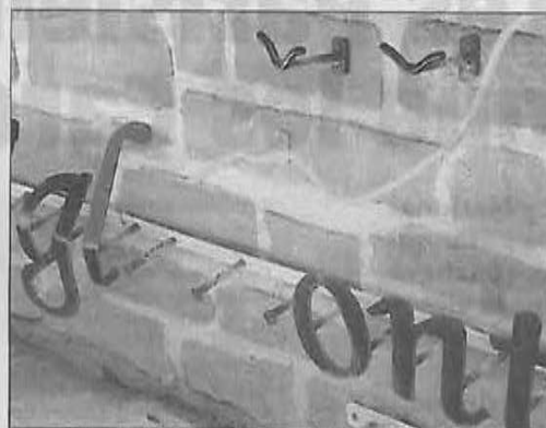
Gros plan sur une des inscriptions détériorées. Les lettres métalliques ont été tordues ou cassées. Du pur vandalisme !
